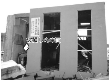
写真40 倒壊したビル
