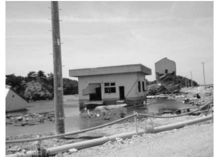
写真24 水没状態の建物
