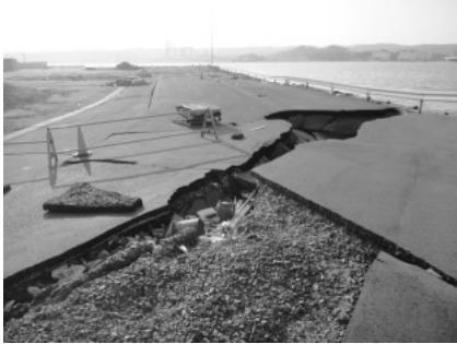
写真15 崩壊した湾岸道路
