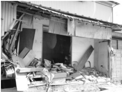
写真31 全壊状態の家屋
