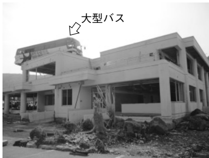
写真44 全壊した公民館の状況
