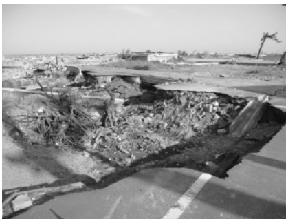
写真12 海岸部に向かう道路の陥没箇所
