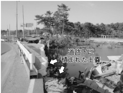
写真11 道路脇の陥没・水没箇所
