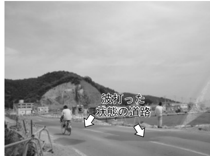
写真28 沿岸部道路の歪んだ状況
