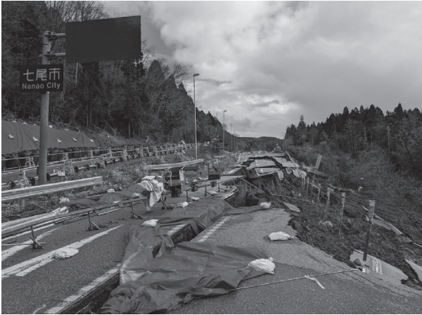
写真1 崩落した道路
